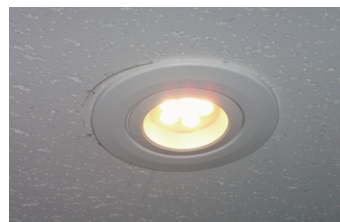
エレベーターホールに設置されたLED照明
