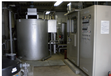
廃水処理設備
