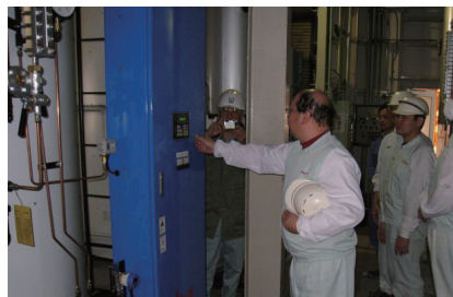
サンハウス食品の新型ボイラー
