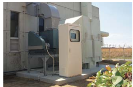
静岡工場に導入された脱臭設備
