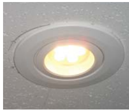
エレベーターホールに 設置されたLED照明
