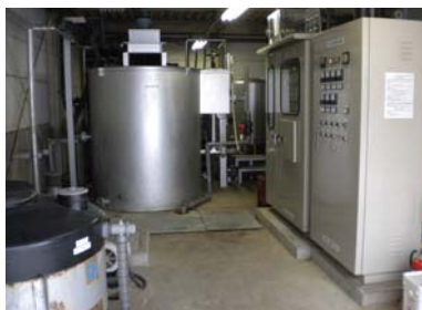
排水処理設備
