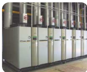
関東工場ボイラー設備
