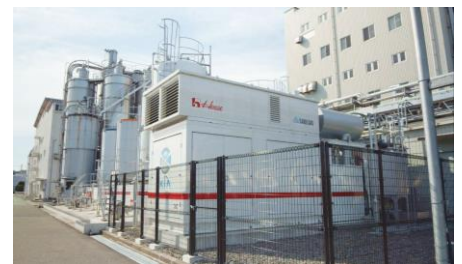
福岡工場 ガスコージェネレーションシステム外観
